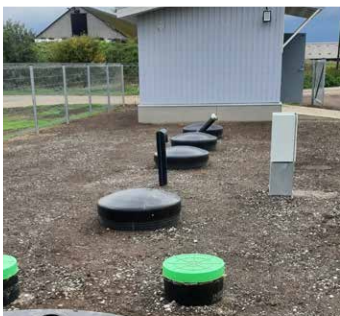
Kuivajõe küla uus reoveepuhasti.
